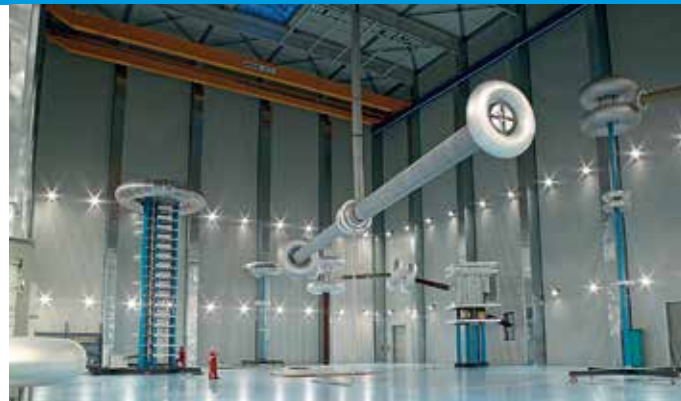
800 kV Wanddurchführung im HSP-Prüffeld
