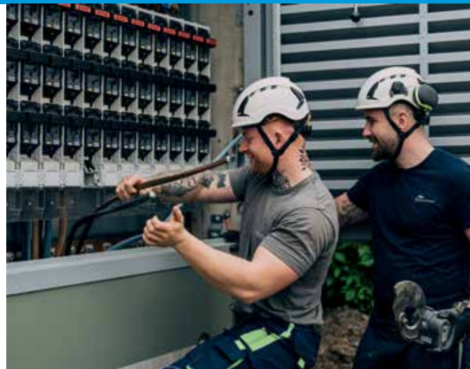
Trafostation der Stadtwerke
