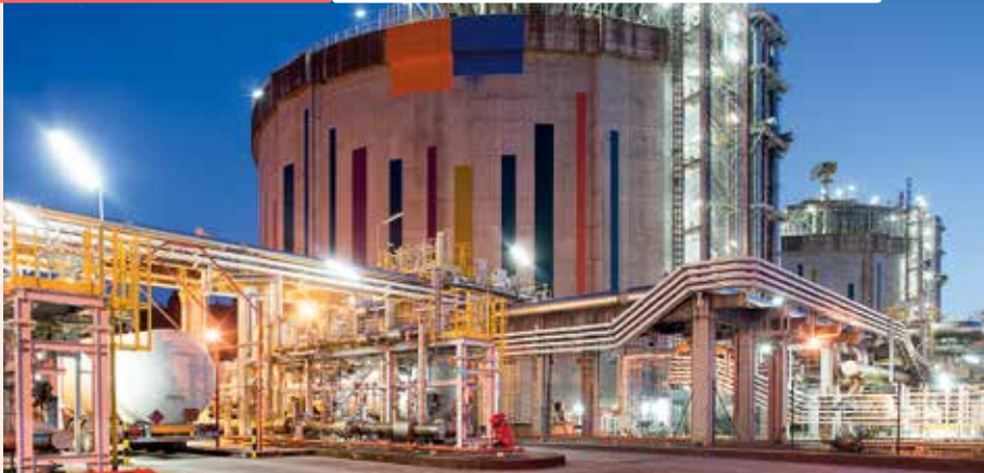
LNG Terminal Reganosa, Spanien | Alle Fotos: © TGE Gas Engineering GmbH
