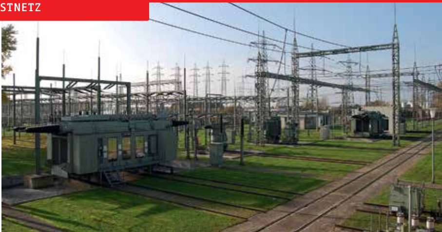
110.000 Volt fließen durch die Schaltanlage | Alle Fotos: © Westnetz GmbH
