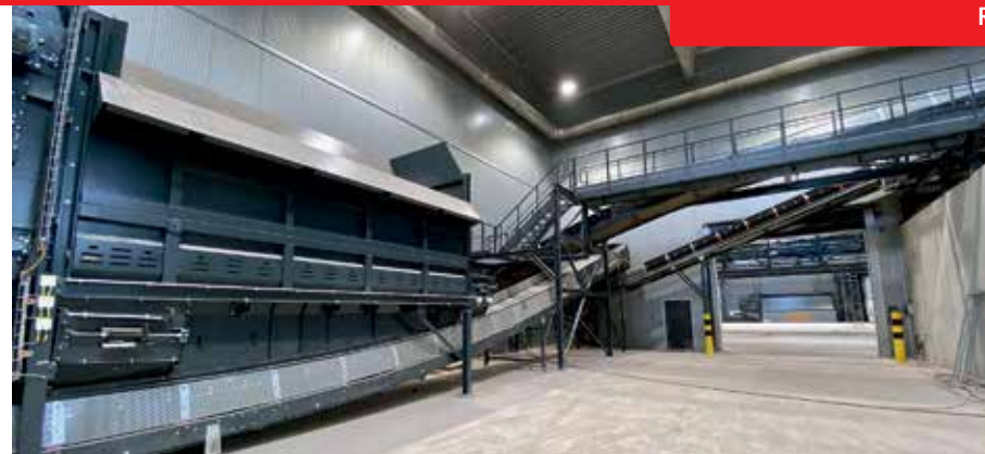
Blick in die Anlieferhalle mit Mischer und Fördertechnik
