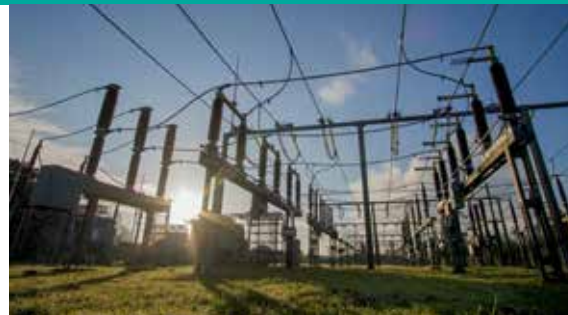
Alle Fotos: © Westenergie AG
