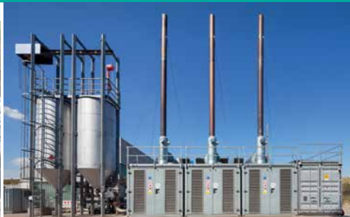
Blockheizkraftwerk zur Produktion von Strom aus Deponiegas | Alle Fotos: © AVG Köln mbH
